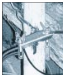
Bild 3: Die ungeeignete Antennenschelle bietet nicht genug Auflagefläche (VDE 0855 empfiehlt 100 mm 2 ), um das Erdungskabel korrekt mit dem Mast zu verbinden.
